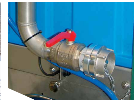
C-Anschluss zur schnellen Befüllung des Tanks
