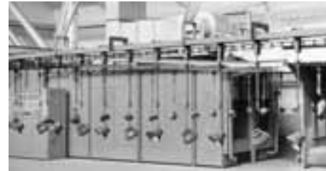
Modern eingerichtete Spritzlackieranlage mit einem 18-Meter-Infrarot-Einbrennofen.
