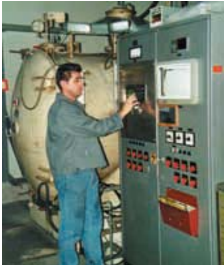
Vakuumofen im Werk Böisingen.
