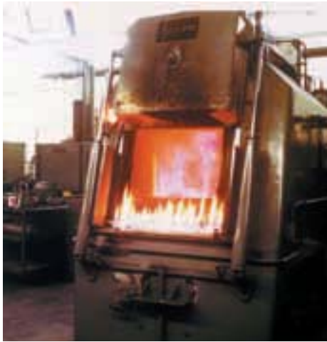
Moderne Schutzgasanlage im Betrieb Fällanden.
