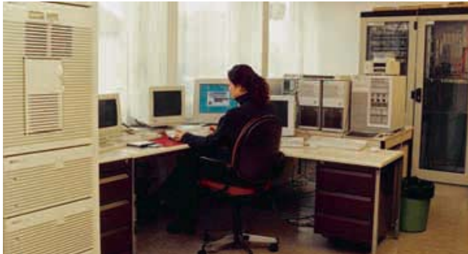
Der heutige Systemraum für das PC-Netzwerk.
